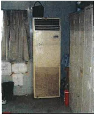
写真 3：休憩所に設置したエアコン
